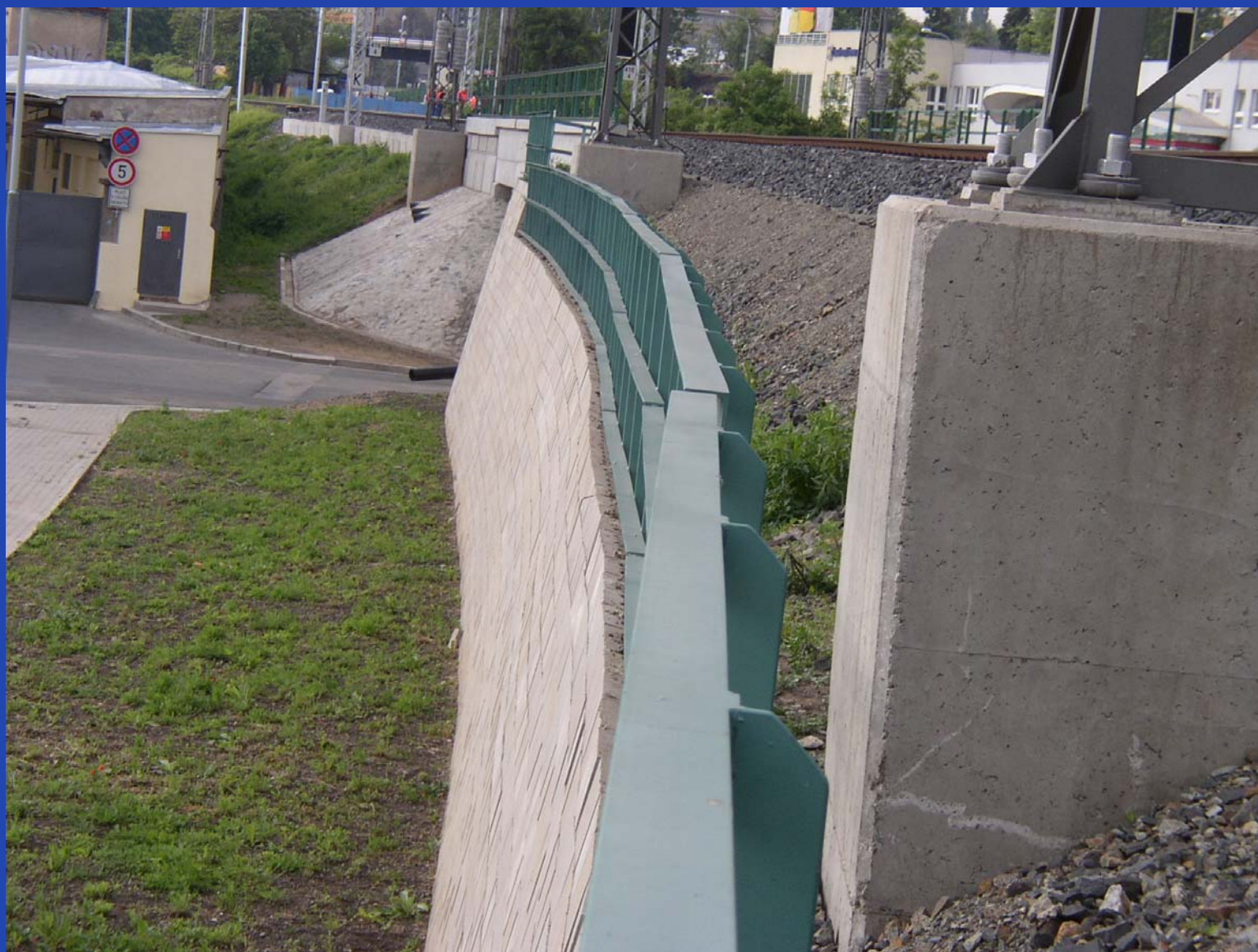
Deformace horní části zdi
